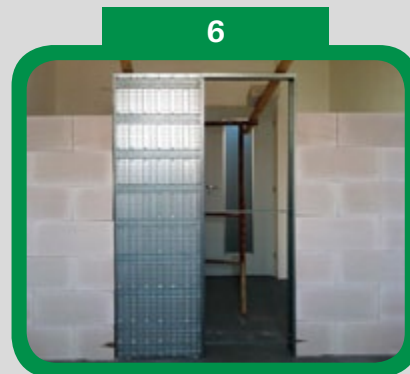
Zazděné stavební pouzdro v příčce (Pozor - nad pouzdrům musí být překlad)
